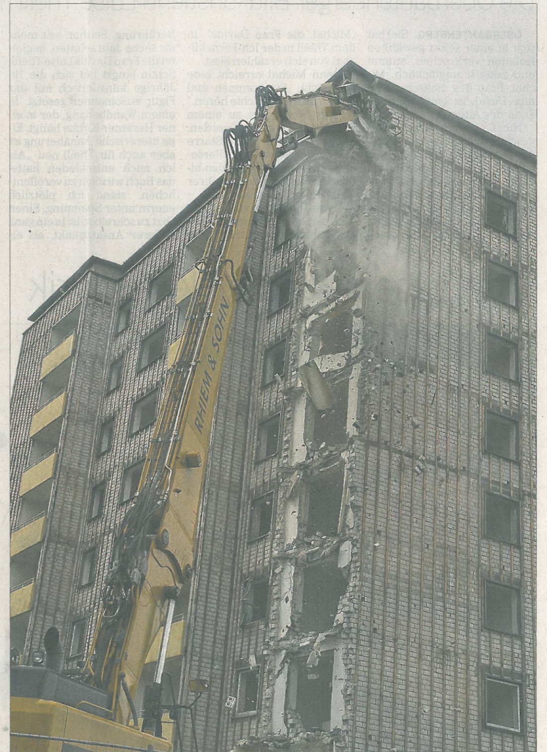
In der Nacht zu gestern war der Bagger angekommen, kurz nach Mittag begann der Abriss des 40 Jahre alten Mietshauses Schöne Aussicht 54. Zehn Tage sind für den Abbruch angesetzt. (Fotos: Krempin)
